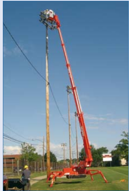
LEO 26 T - Inspektion/Wartung Lichtenlagen
